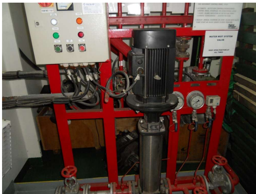
Figura 3.1 – Gruppo di pompaggio sistema Water Mist
