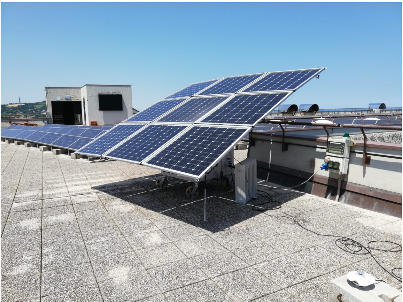
Fig. 5.1 Il generatore fotovoltaico durante le misure effettuate nel mese di giugno.
