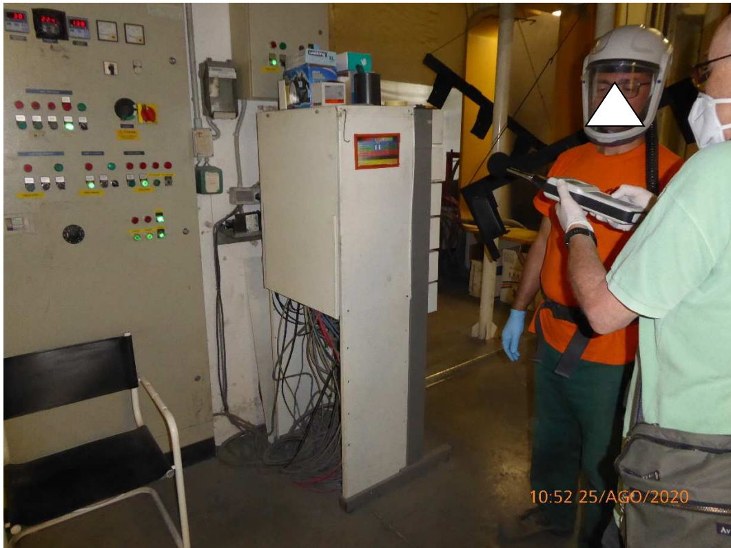
Figura 17 – Mansione 1, Compito 1.4, Centro di controllo verniciatura robotizzata
