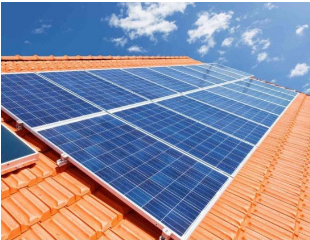
Figura 5: Impianti fotovoltaici installati.
