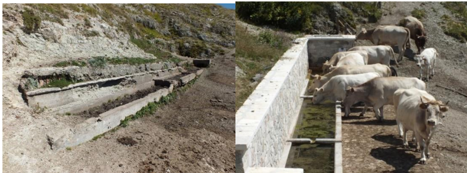
Figura 3 e Figura 4 – Il fontanile dei Baconi prima e dopo i lavori ( www.gransassolagapark.it )
