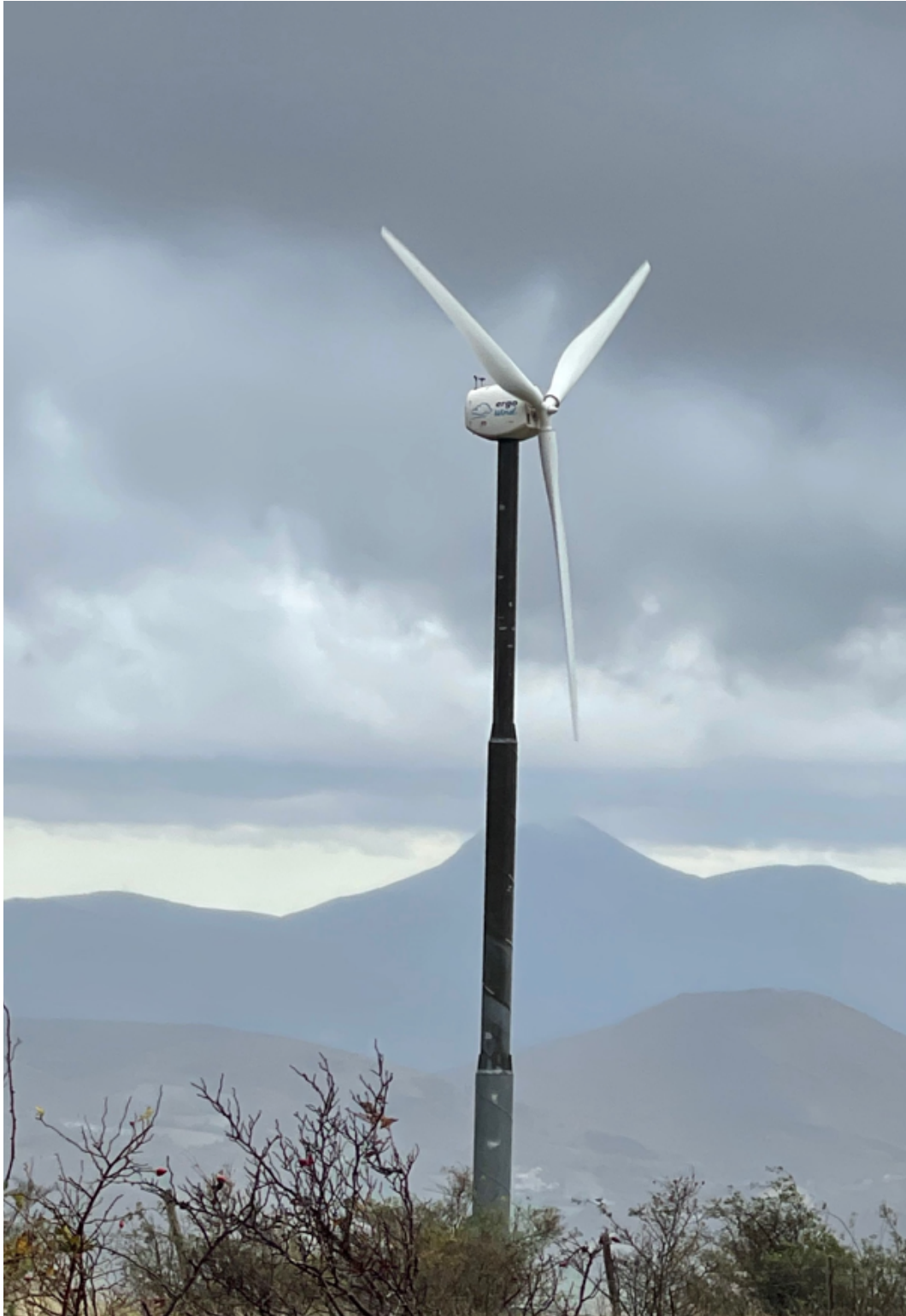
Figura 60: Pala eolica di Sassoferrato
