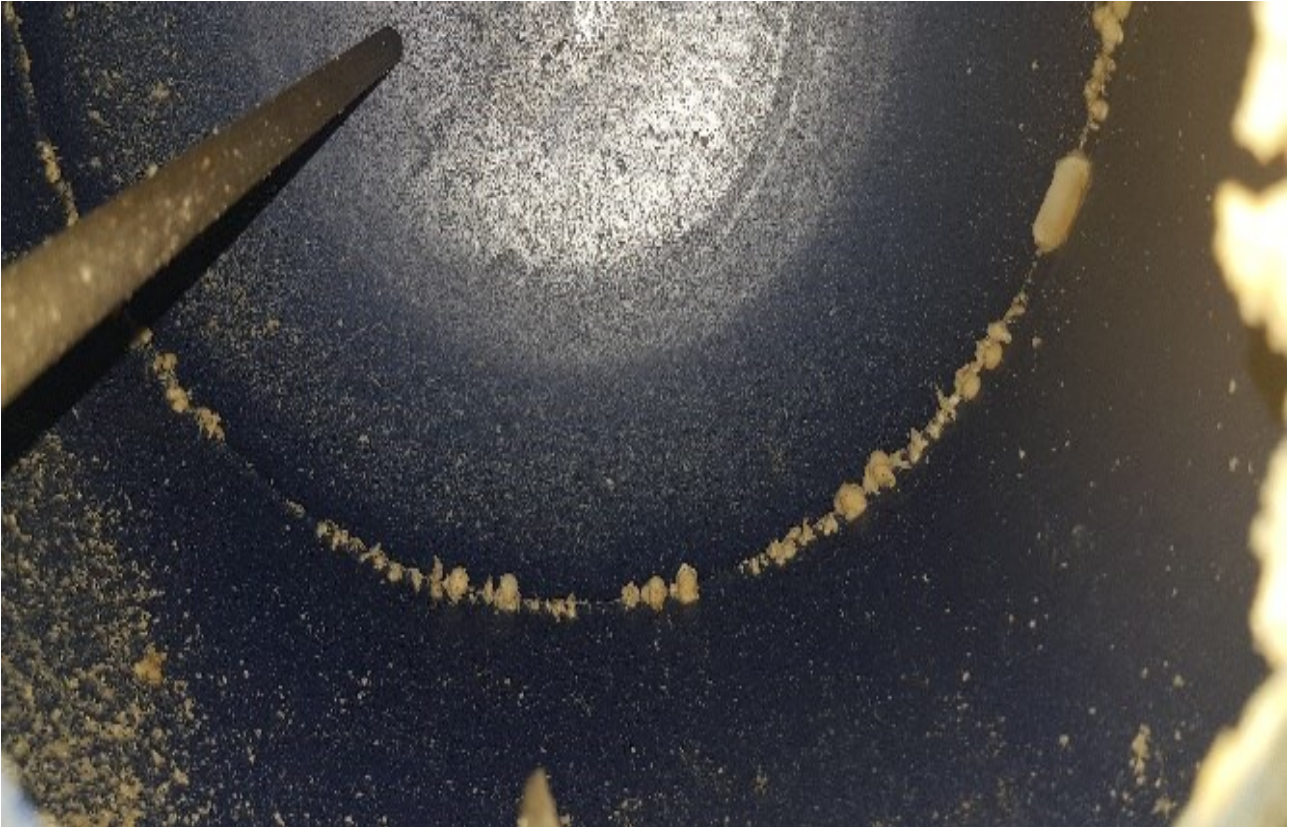
Figura 1.4 ( Corrosione) : In questa immagine notiamo come lo smalto, non riesce ad aderire perfettamente. Nelle zone in cui succede potrebbe generare dei spessori di smalto insufficienti e questo potrebbe portare a fenomeni di corrosione.
