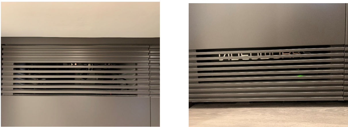
Figura 7 - Bocchette di aerazione Rack
