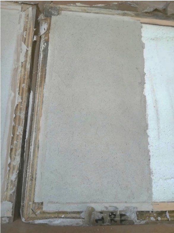
Figura 5.24: getto ARF con presenza di fessurazioni sulla superficie
