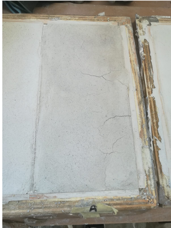
Figura 5.25: fessure sulla malta A
