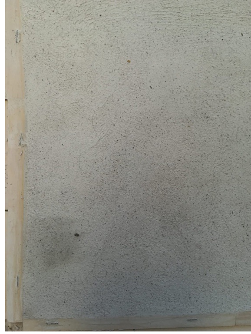
Figura 4.22: Dettaglio della fessura
