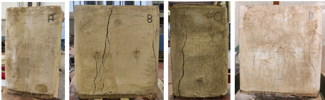
Figura 89_rilievo fotografico in seguito alla prova (RT FRCM_1)
