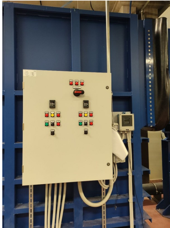
Fig. 6.1.e Sistema di controllo per l'azionamento delle pompe posto in testa al canale idraulico
