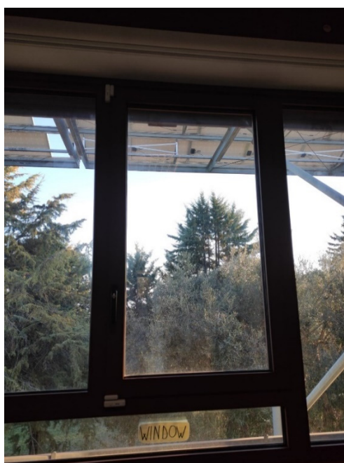
Posizionamento della "WD8" che segnala l'apertura completa della finestra e "WD9" che segnala l'apertura a vasistas della finestra
