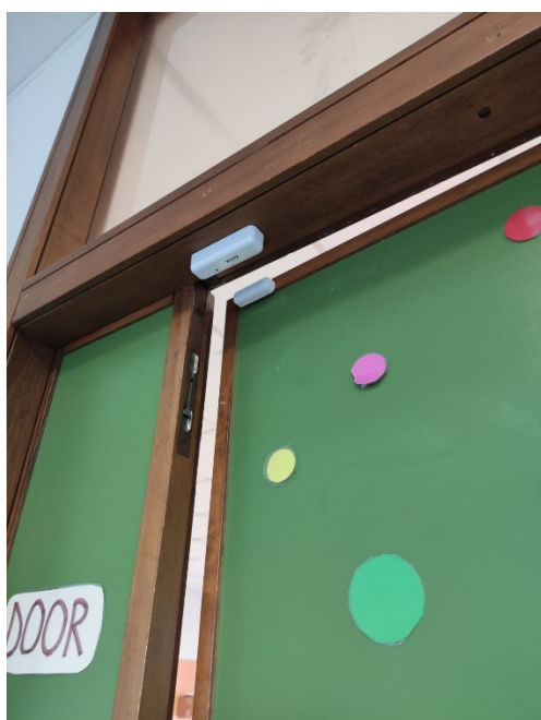
Sensore WD12 installato sulla porta
