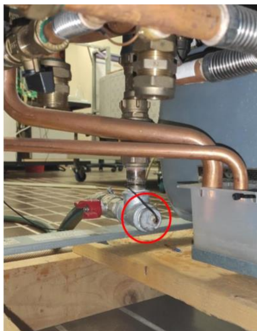
Figura 17-Pozzetto per la termocoppia sul lato di ritorno dell'acqua calda
