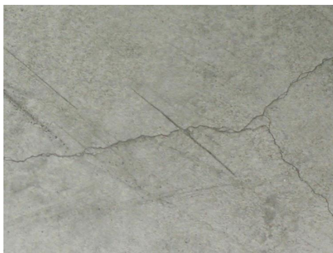
Figura 2.1: Fessurazione da Ritiro
