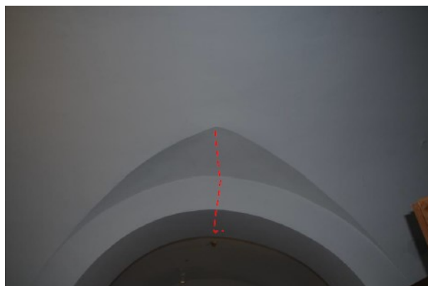
Fig. 15 – Danno strutturale stanza L2 02
