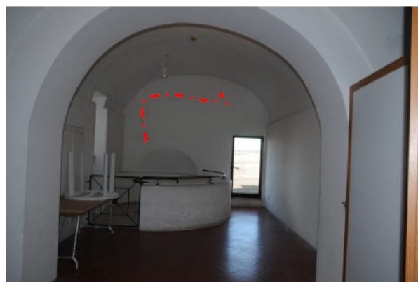
Fig. 16 – Danno strutturale stanza L2 03
