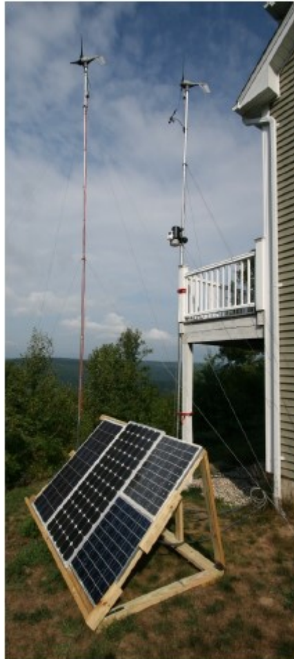
Figura 6: Pannelli solari installati nella Casa C
