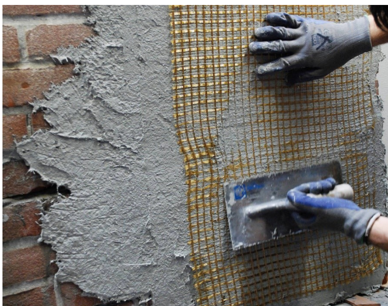
Figura 2.13 – Esempio di posa in opera di rete di rinforzo in fibra PBO
