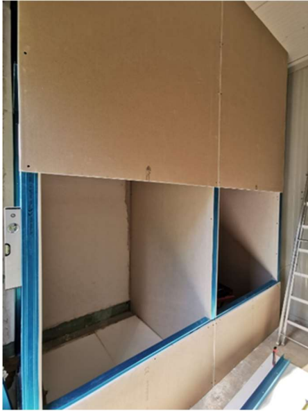
Figura 50- Realizzazione box di monitoraggio
