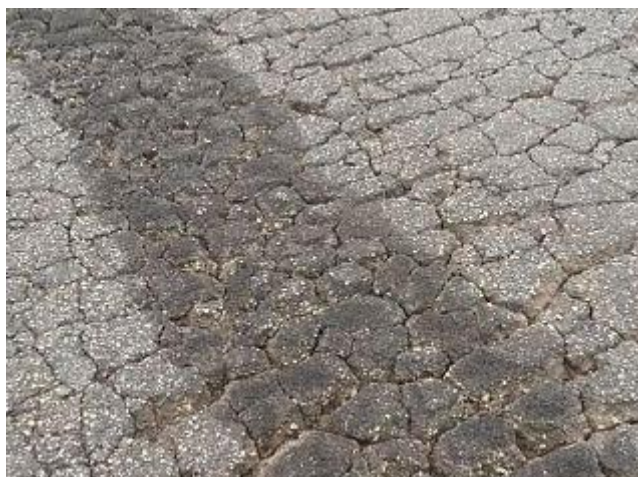
Figura 2.2 – Fessurazione a pelle di coccodrillo
