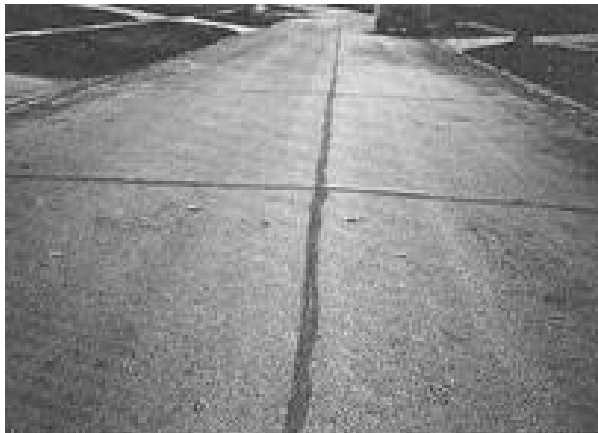
Figura 2.3 – Fessurazioni di riflessione del giunto
