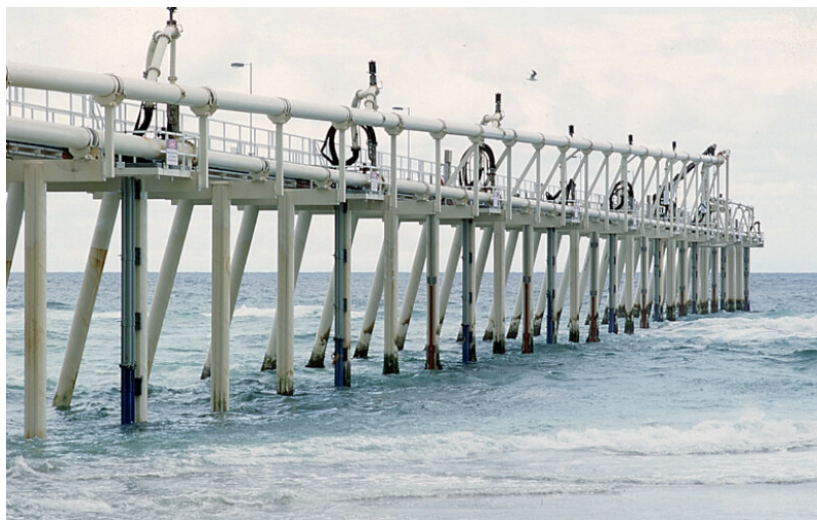
Fig. 13: Pipeline su rotta marina del complesso del fiume Tweed in Australia
