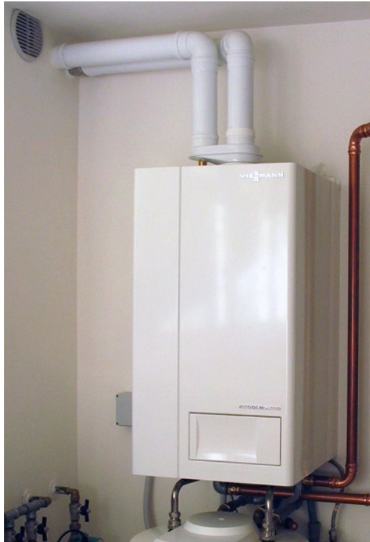
Figura 1-2: Caldaia alimentata a metano
